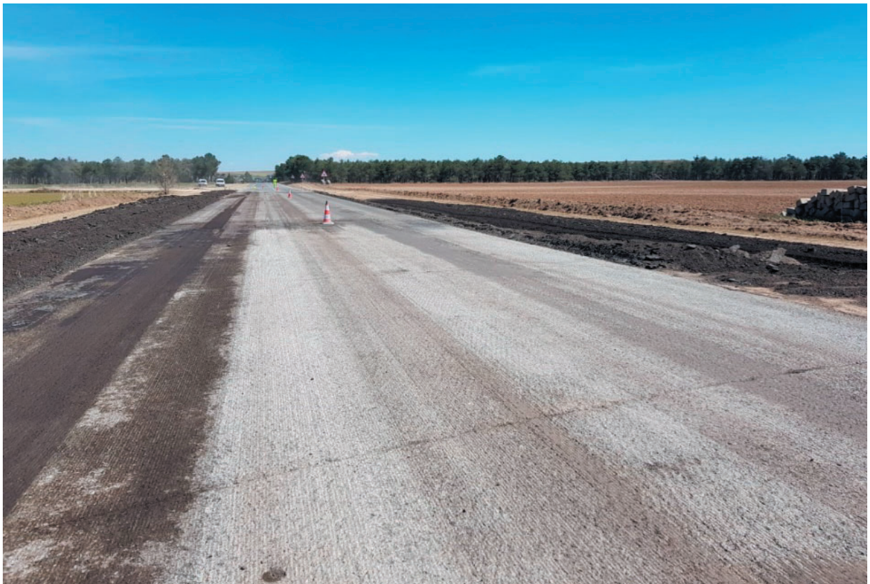
Hormigón HCR tras el fresado de la mezcla superior. (Foto tomada en el año 2021).
